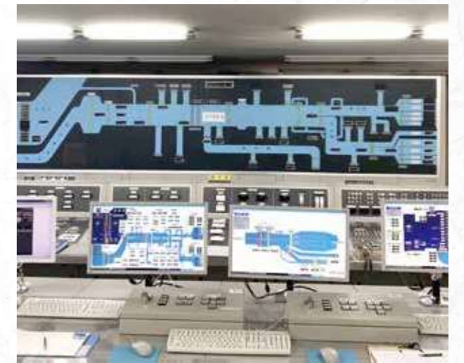
水源管理所 遠方監視制御施設
