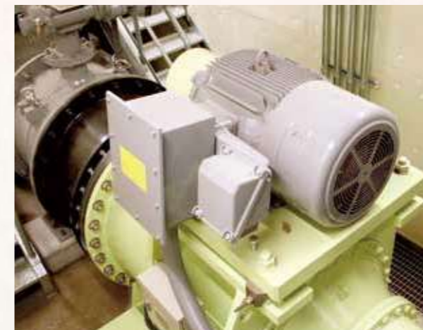
プロペラ水車発電機(中井筋発電所)
