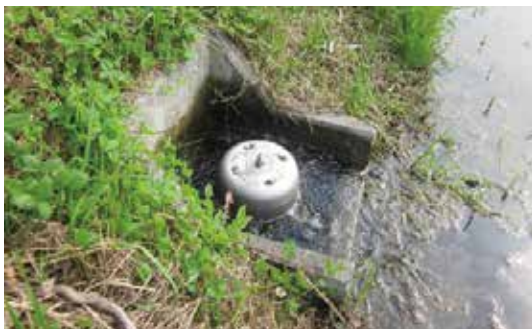
田用給水栓（写真①）
