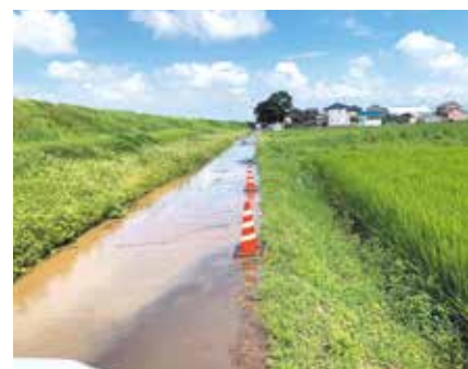
漏水事故（西尾市志貴野町地内）
