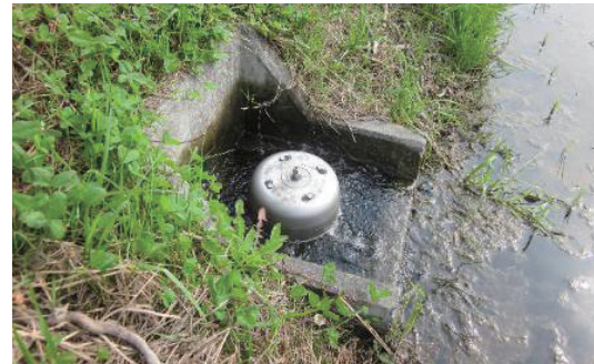
田用給水栓 (写真①)
