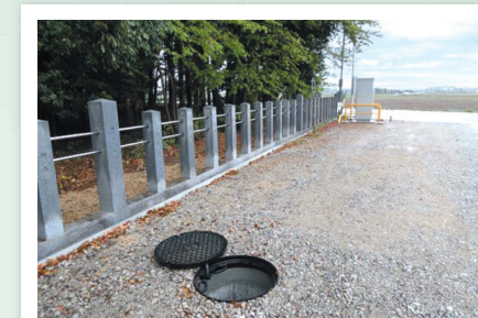
東高根地区(流量計設置)/遠方監視整備工事(遠景)
