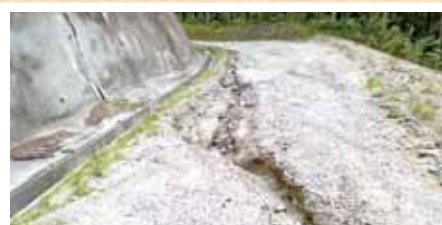
写真③ 路面浸食
