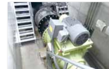
▲プロペラ水車発電機
