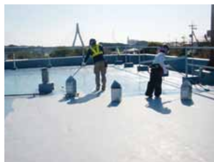
明治頭首工地区（豊田市水源町） 管理所屋上防水塗装状況
